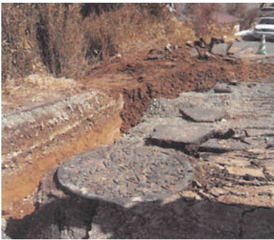
崩落した道路
